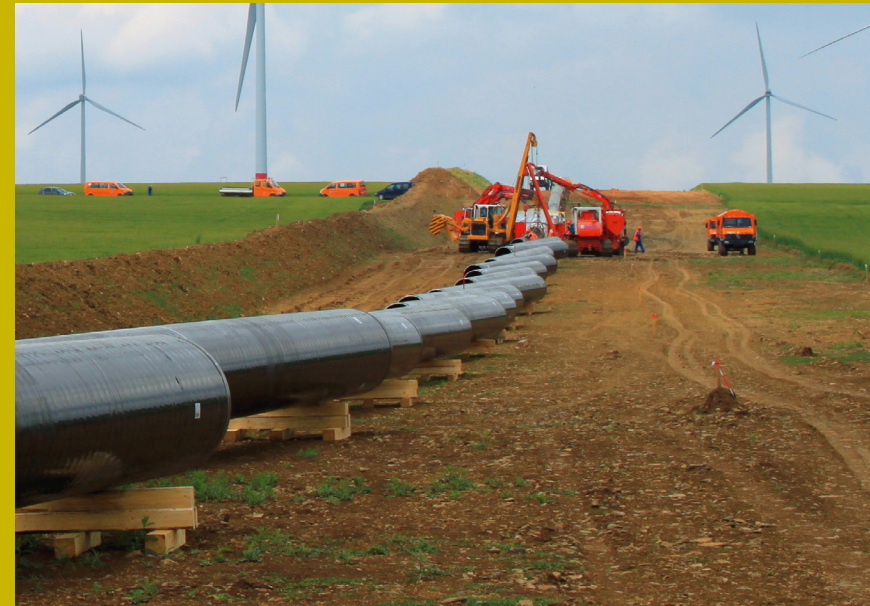
Gaspipeline der OGE (Quelle aller Bilder: OGE)
